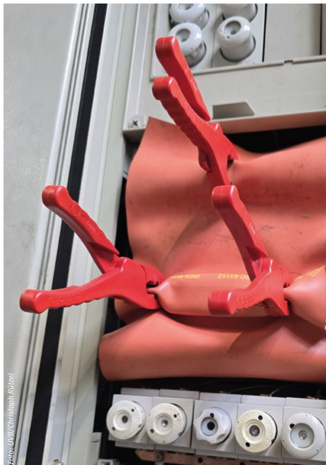
Abbildung 5: Benachbarte, unter Spannung stehende Teile abdecken oder abschränken
