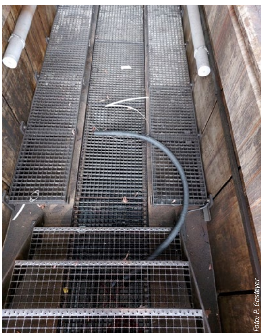
Abbildung 3: Umknickgefahr/ Sturzgefahr durch abgelegten Schlauch im Treppenbereich
