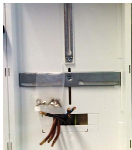
Abbildung 6: Dreipunkt-Zählerfeld nach DIN 43870 (Ausschnitt) (Foto: DB Energie/D. Fijol)
