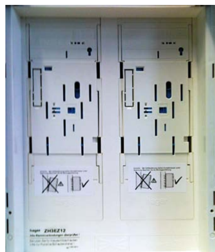
Abbildung 5: eHZ-Zählerplatz nach DIN 43870-1/A1 für zwei Zähler (Foto: DB Energie/D. Fijol)
