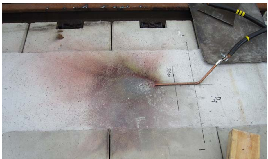
Abbildung 5: Fehlerstelle nach Kurzschluss (Foto: Christian Budde)
