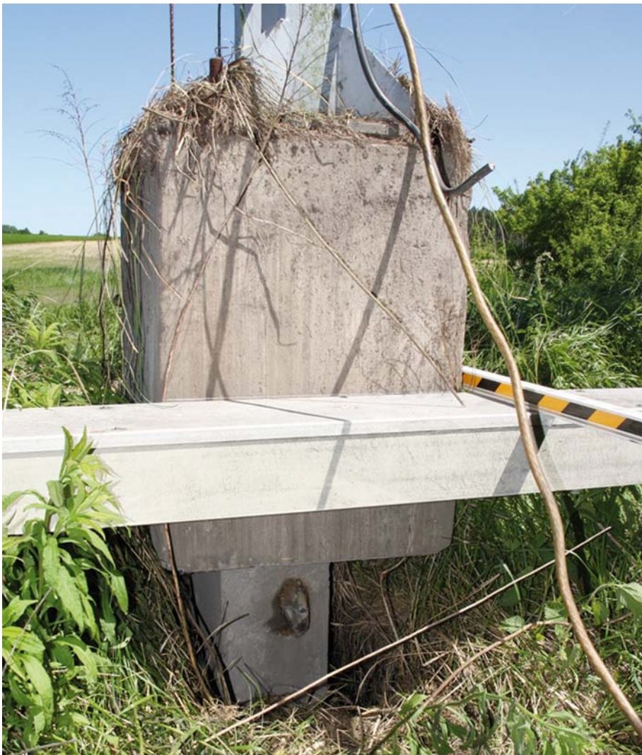
Abbildung 1: Schaden am Fundament eines Oberleitungsmastes (Foto: DB Netz AG)
