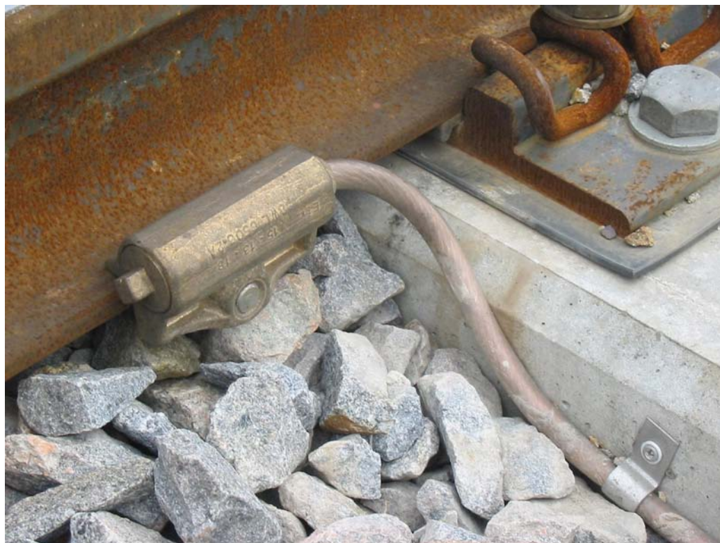
Abbildung 7: Anwendungen einer SDS: Installation an der Fahrschiene bei Gleisstromkreisen.
