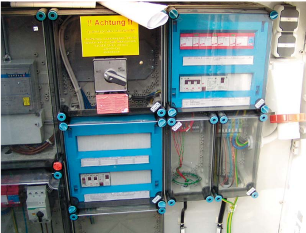
Abbildung 5: Überspannungsschutz für Niederspannungsversorgung von Mobilfunkstation GSM-R.
