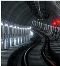
Unser Titelbild: Tunnel-Sicherheits- Beleuchtung auf der Berliner Nord-Süd- Verbindung. Foto: DB AG/Christian Bedeschinski.
