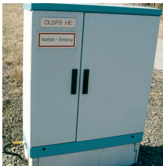
Abbildung 5: Schaltschrank einer OLSP.
