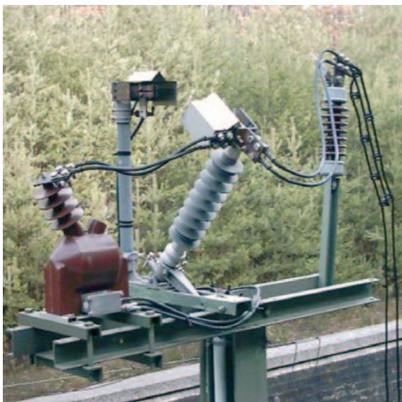
Abbildung 3: Masterdungsschalter einer Oberleitungsspannungsprüfeinrichtung (OLSP).
