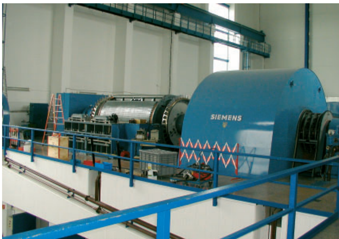
Abbildung 13: Geöffneter Bahnnumformer nach Feststellen von Schäden in den Polbefestigungen.
