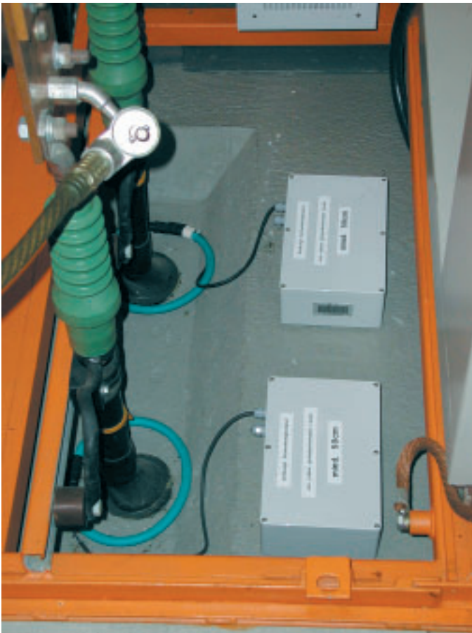
Abbildung 6: Eingebaute \rho^2 -Messgräte (Messung im Uw Mainbernheim).
