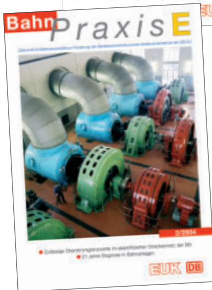
Unser Titelbild: Die Turbinenhalle des Wasserkraftwerks Bad Reichenhall. Foto: DB AG/Lautenschläger.
