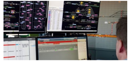
DB InfraGO AG – Leit- und Sicherungstechnik – Zentralstellwerk „Bf“ in Mainz-Bischofsheim (Bauform Sp Dr S 60)
