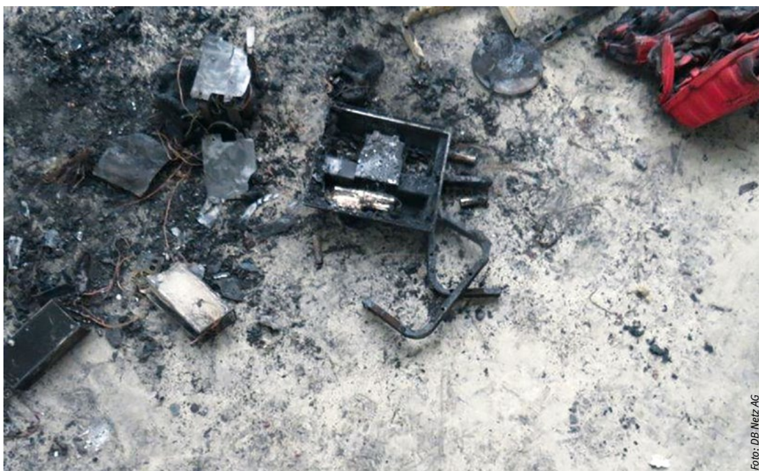
Abbildung: Überreste einer brandauslösenden Ladestation
