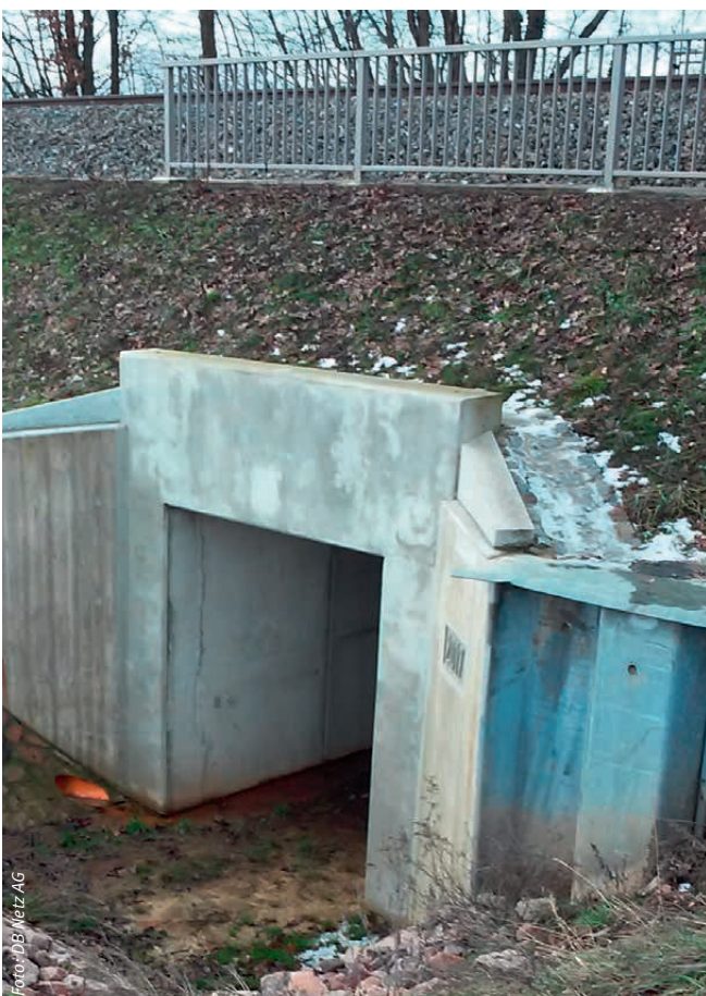
Abbildung 4: Montage eines Geländers erfolgte nicht an der Absturzkante
