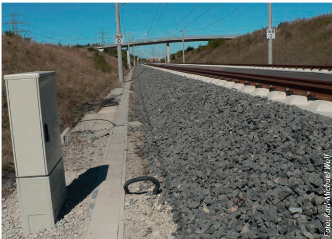
Abbildung 1: Schaltstrank mit zum Gefahrenbereich des Gleises ausgerichteter Öffnungsseite
