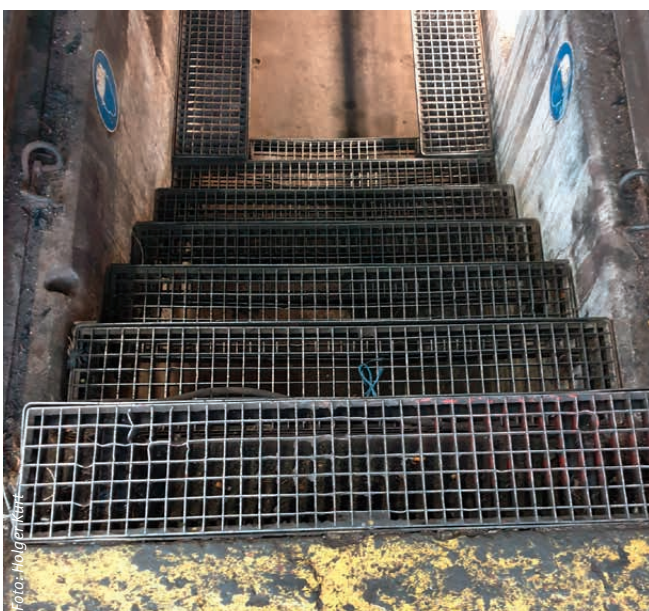
Abgenutzter Treppengitterrost/fehlender Boden-Gitterrost
