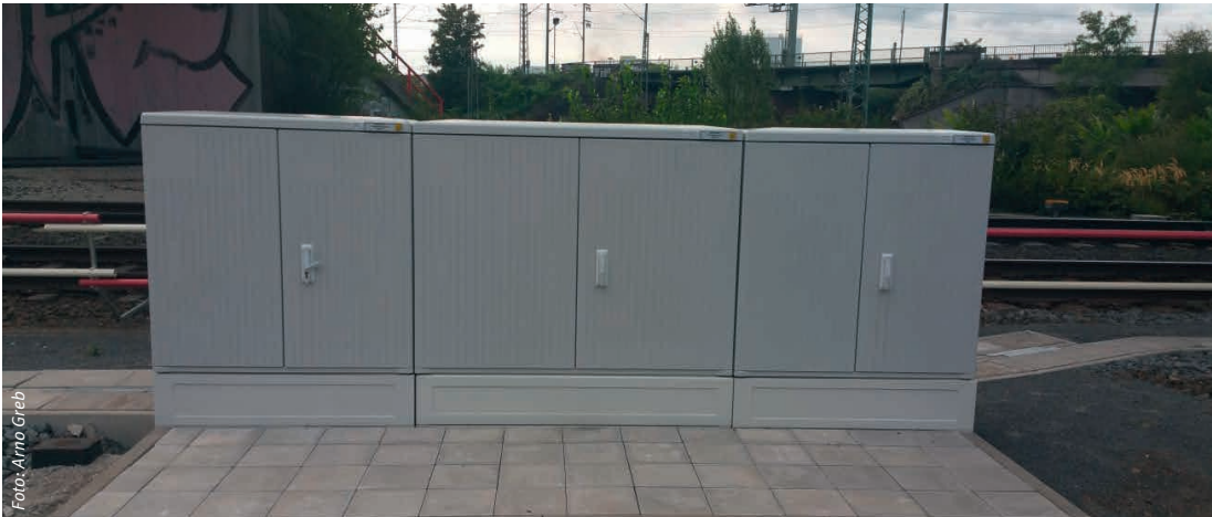
Abbildung 3: Schaltschrank mit zur Feldseite (gleisfreien Seite) ausgerichteter Öffnungsseite und Standfläche für Arbeiten
