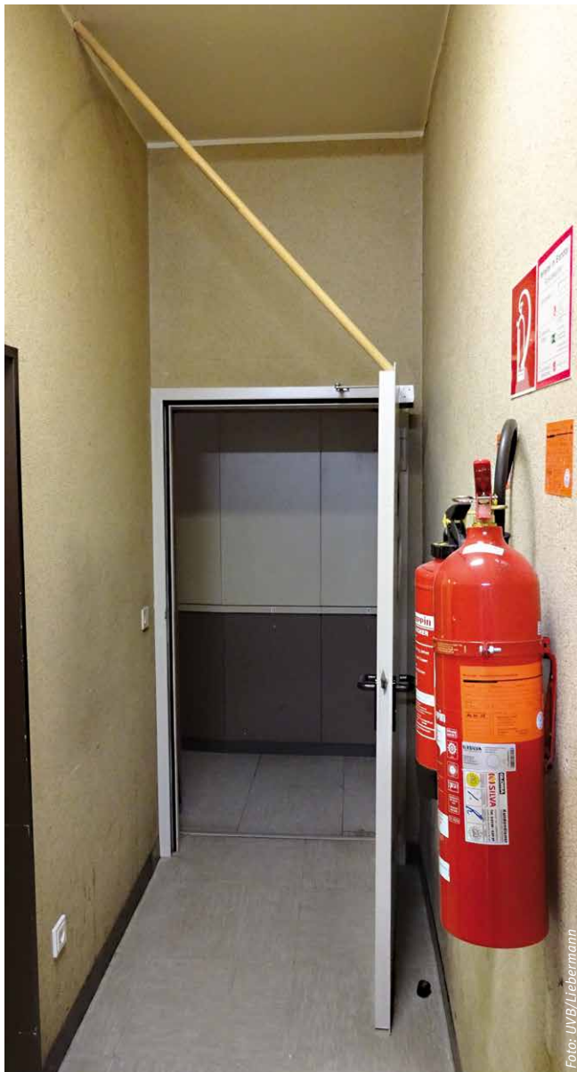
Abbildung 1: Festgestellte Brandschutztür; Feuerlöscher zu hoch aufgehängt
