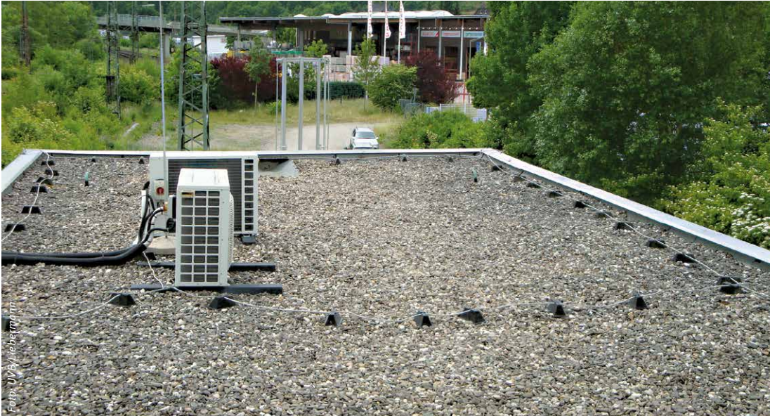
Abbildung 4: Ungünstiger Verlauf des Fluchtweges zur Steigleiter (Notabstieg): Stolperstellen (Blitzableiter) im Fluchtweg sowie Absturzgefahr am Einstieg zur Steigleiter (Notabstieg)
