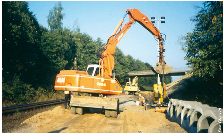
Abbildung 4: Hier fehlt eine Feste Absperrung bei umfangreichen Tief- und Gleisbauarbeiten neben einem Betriebsgleis. Für die Bagger sind zusätzliche Sicherungsmaßnahmen erforderlich, um eine Gefährdung für den Bahnbetrieb auszuschließen. Der erforderliche Schutzabstand zur Fahrleitung ist einzuhalten, Bahnerdungen sind einzusetzen.
