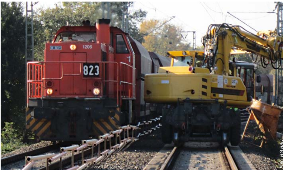
Abbildung 6: Einsatz einer FA im Mittelkern bei 4 m Gleisabstand (80 km/h im Nachbargleis, Lü während der Arbeiten ausgeschlossen).
