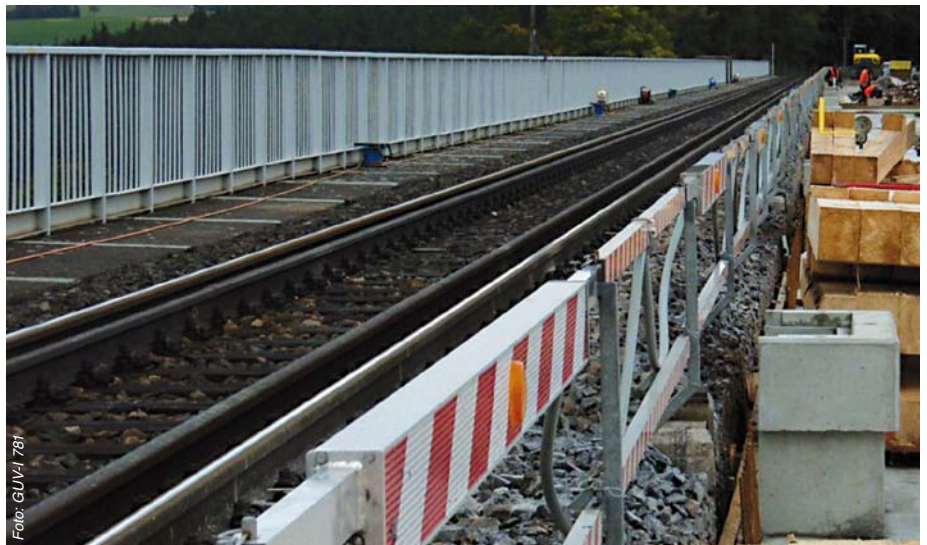
Abbildung 10: Automatisches Warnsystem mit integrierter Fester Absperrung bei beengten Platzverhältnissen (Sanierung der Fahrbahnplatte einer Brücke). Die Beschäftigten müssen den Arbeitsbereich unmittelbar neben der Fester Absperrung nach der Warnung verlassen.
