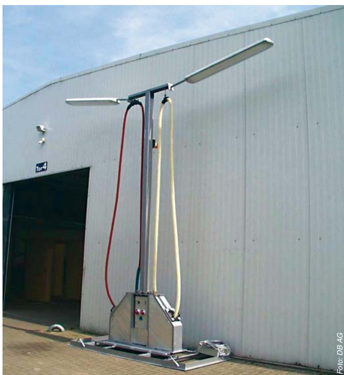
DB Trinkwasser-Befüllungsanlage T-System
