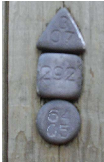
Abbildung 6: Kennzeichnung am Mast. Auf dem runden Mastnagel ist die Nummer des Tränkwerkes Nr. 64 und Tränkjahr 05 (für 2005) abzulesen
