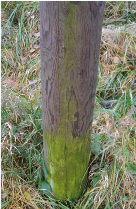
Abbildung 5: Durch eine nachträgliche Sichtprüfung ist der fachgerechte Masteinbau in der Regel nicht feststellbar
