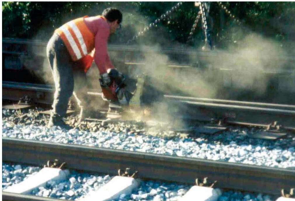
Abbildung 4: Unzulässiger Einsatz eines Schienentrennschleifgerätes: Bei Reaktion des Beschäftigten auf ein Warnsignal ist damit zu rechnen, dass er in den Gefahrenbereich des Nachbargleises hineingerät. Der Sicherheitsraum fehlt. Für das Signalhören zugelassener Gehörschutz und Kopfschutz sind erforderlich. Die Warnweste ist geschlossen zu tragen.
