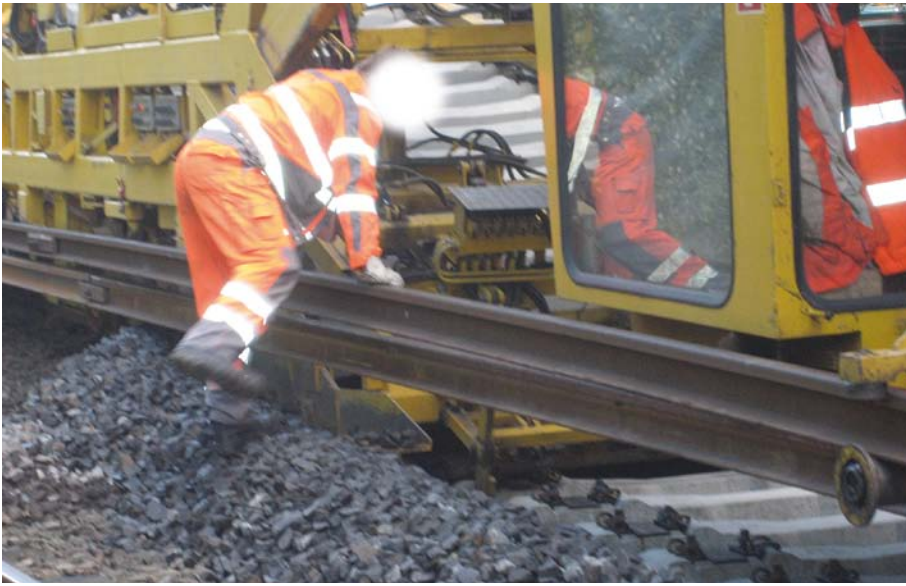
Abbildung 9: Auf dem Schotterberg im Mittelkern ist ein sicherer Auftritt nicht möglich.
