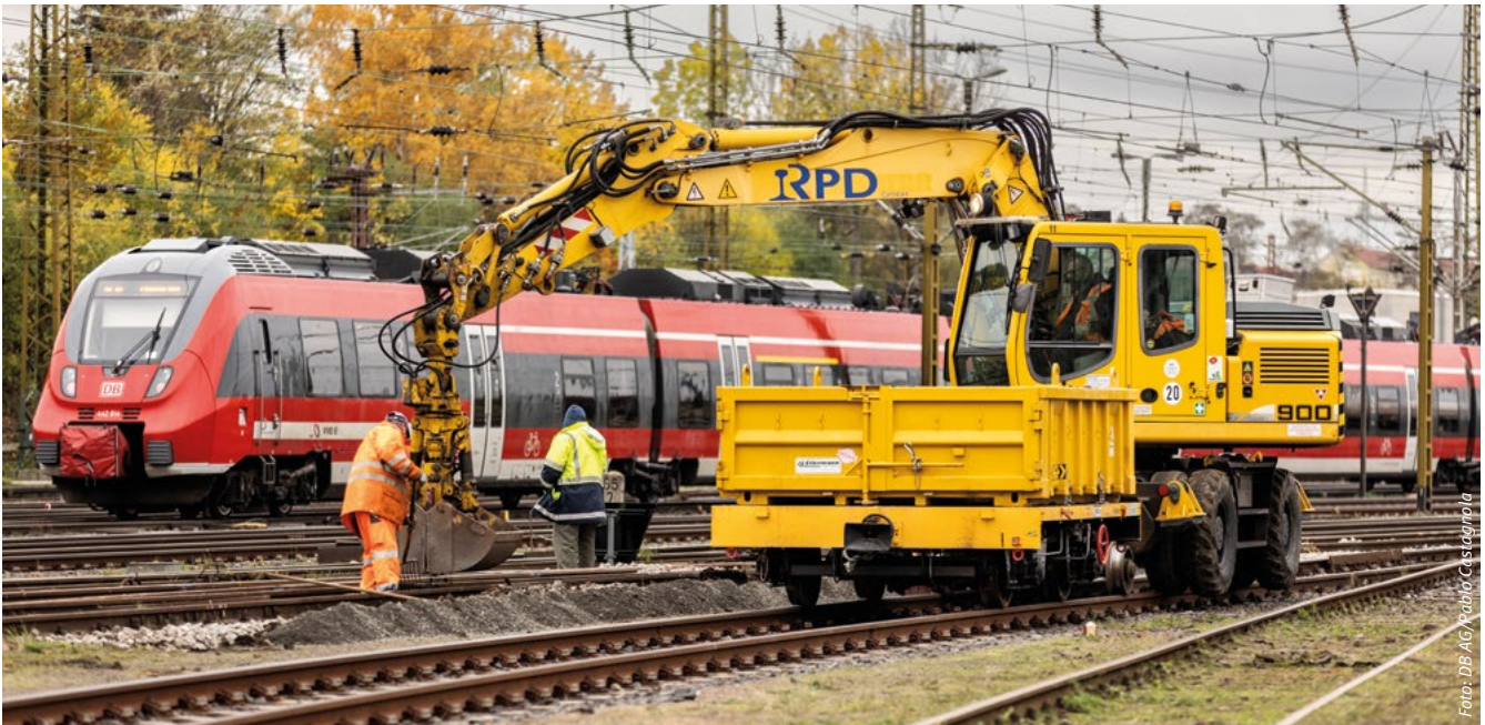
Abbildung 5: Vorsicht – Rückleitung des Stroms muss gewährleistet sein
