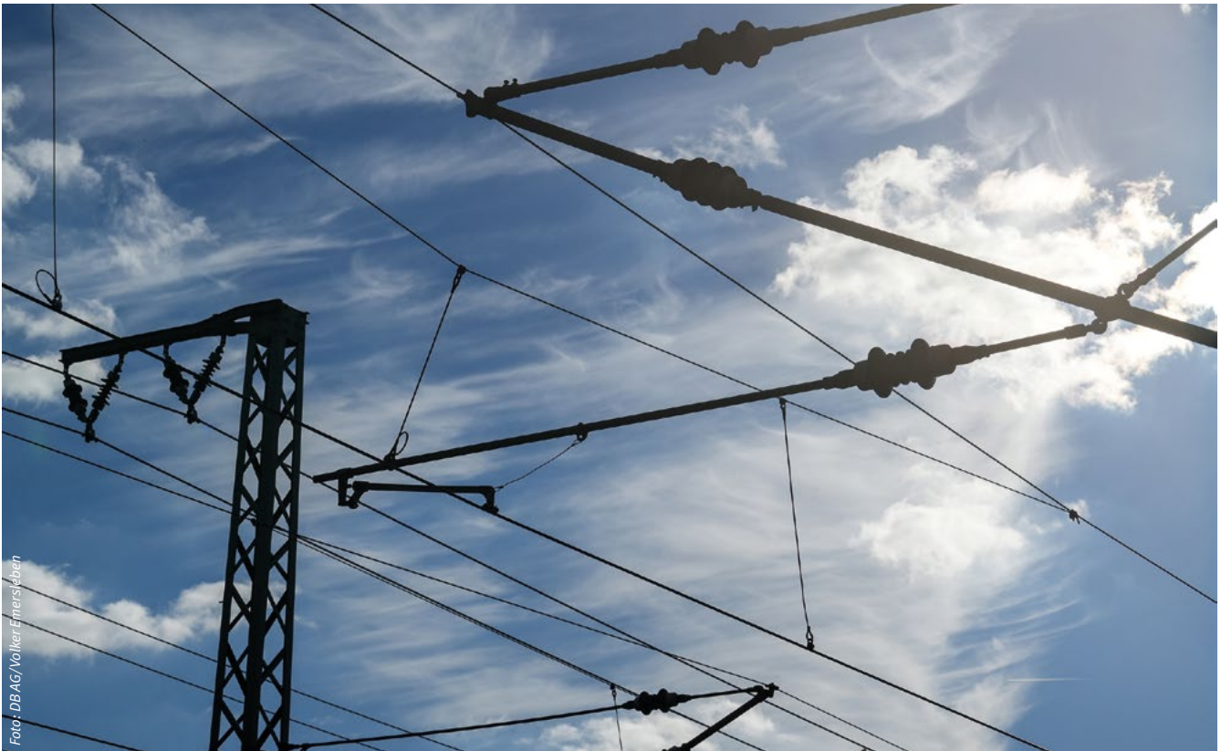
Abbildung 3: Unter Spannung stehend ist nicht nur der Fahrdrat über der Gleisachse, sondern auch die stützenden Konstruktionen
