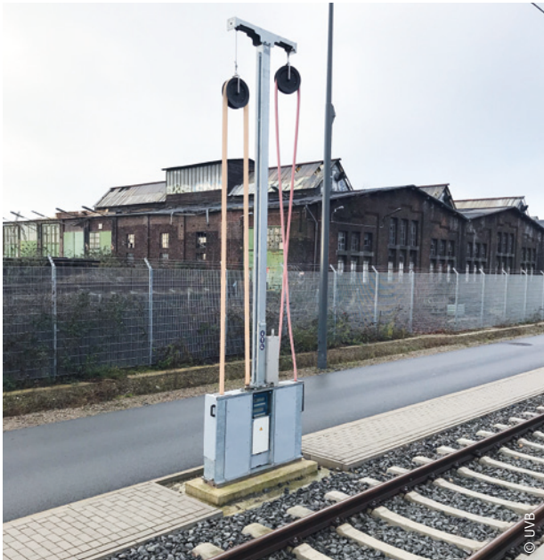
Abb. 4: Ver- und Entsorgungsanlage mit Schlauchhalterungen
