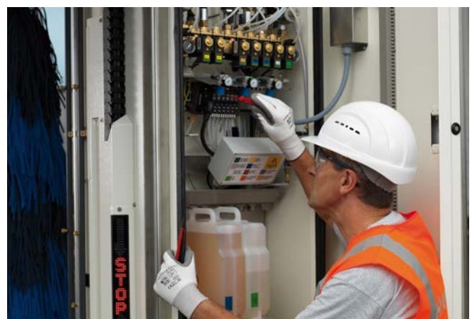
Abb. 14 Arbeiten an elektrischen Anlagen sind Elektrofachkräften vorbehalten.
