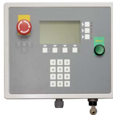
Abb. 19 Bei Betreten der Anlage z. B. für Reparaturen ist vorher der Hauptschalter zu betätigen und gegen Wiedereinschalten zu sichern, z. B. mittels abschließbarem Hauptschalter.
