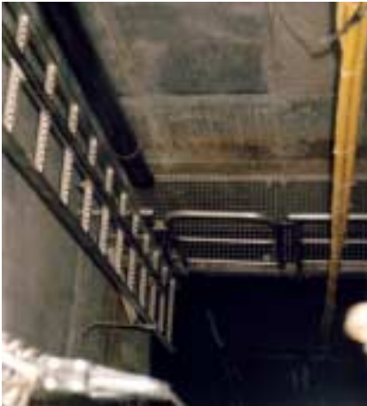
Bild 8: Steigleiter mit Seitenholmen, Steigschutzeinrichtung und Podest
