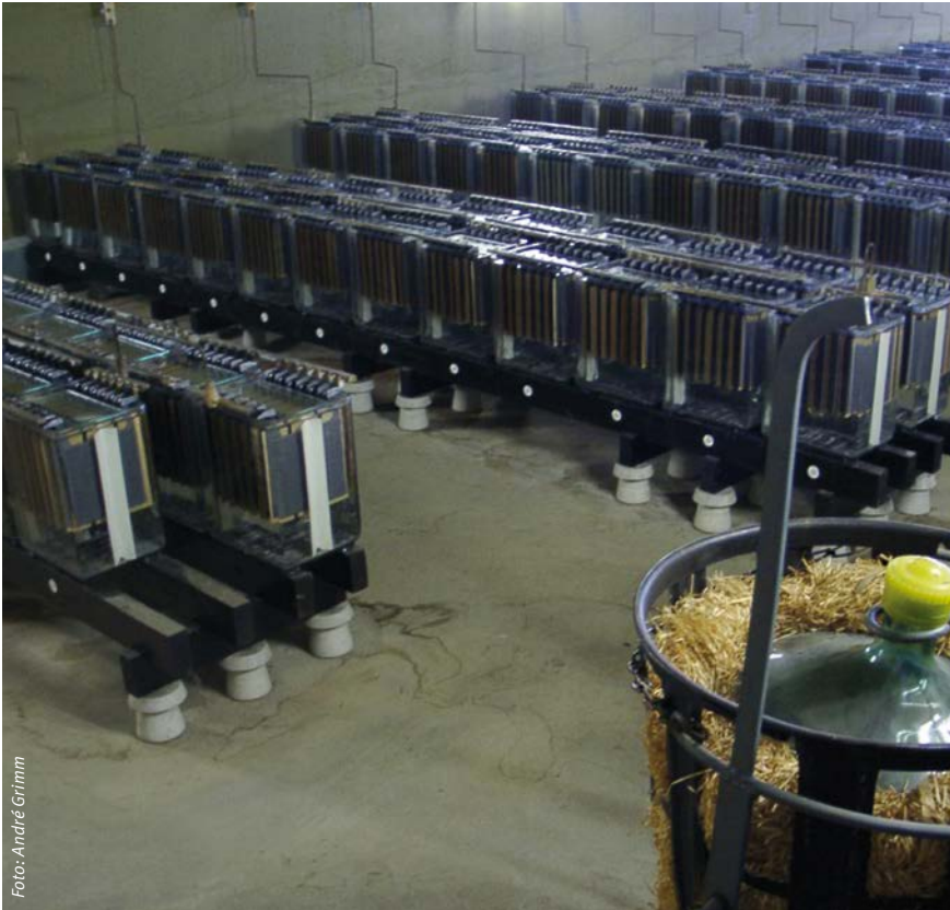
Offene Batterieanlage, die mit dem Unfallbeispiel nicht in Verbindung steht
