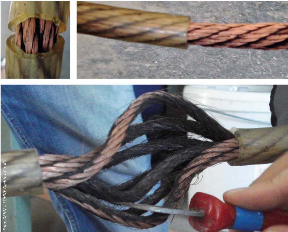
Abbildung 6: Mit dem Verfahren erkannter Fehler im Leiterseil
