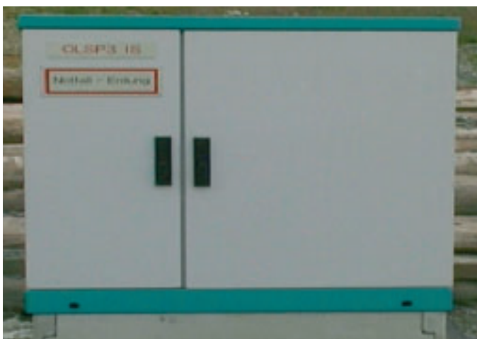
Abbildung 3: OLSP Unterstation mit Bedieneinrichtung im geschlossenen Zustand.
