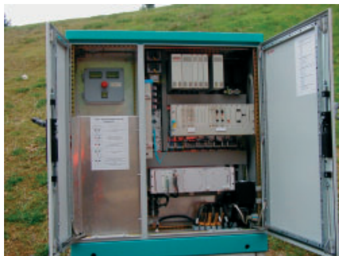
Abbildung 3a: OLSP Unterstation mit Bedieneinrichtung im geöffneten Zustand.
