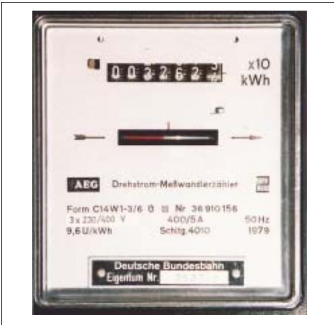
Bild 2 : Vierleiter-Drehstromzähler mit stromseitigem Wandleranschluss 400/5 A. Der Wirkenergieverbrauch kann direkt abgelesen werden (Wert des Zählwerkes multipliziert mit der Ablesekonstante „10“)
