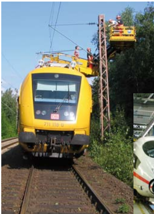
Abbildung 1: Hängetrauma vermeiden durch technische Maßnahmen, z.B. durch Absturzsicherungen in Form von Arbeitskörben ...
