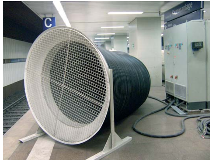
Abbildung 2: Absaugstelle auf dem Bahnsteig der Station Taunusanlage.
