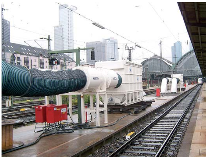
Abbildung 3: Oberirdische Filteranlage am Frankfurter Hauptbahnhof.
