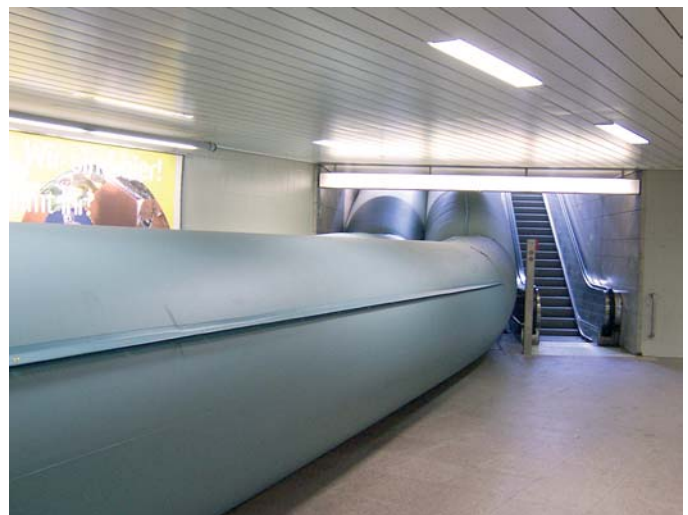
Abbildung 4: Im Tunnelsystem installierte Lutten.
