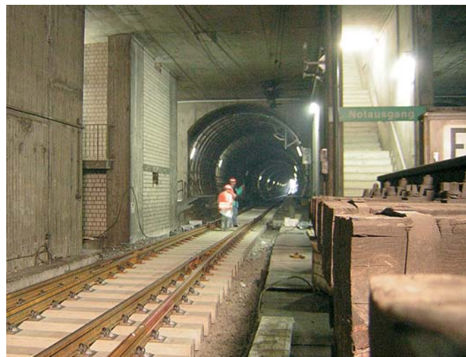
Abbildung 7: Hell beleuchteter Notausgang.
