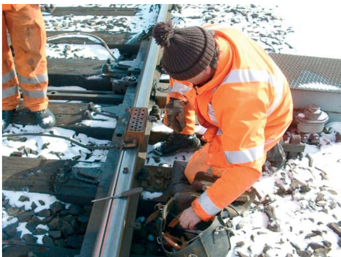
Abbildung 4: Für Fehlerbeseitigung ausgebauter Brennerkasten.
