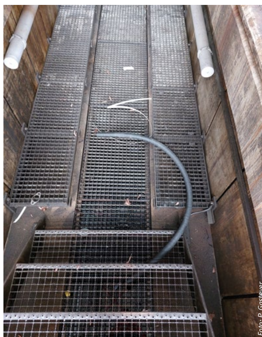
Abbildung 3: Umknickgefahr/ Sturzgefahr durch abgelegten Schlauch im Treppbereich
